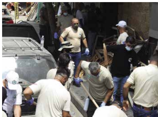
MINERYDDERE: Mer enn 60 av Norsk Folkehjelps mineryddere og ansatte i utviklingsprogrammet har reist fra steder over hele Libanon til Beirut for å jobbe frivillig med å rydde gatene for rester etter eksplosjonen, og bidra til å sikre rasfarlige bygg.
