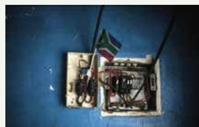
ØDELAGT: Sikringsskapet i huset til Esther Agnes er skadet etter sprengningene fra South32.
